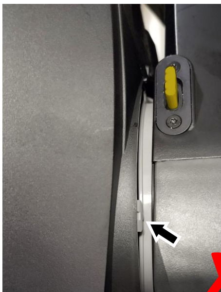
Falsch – Lasche außerhalb der Abdeckung
