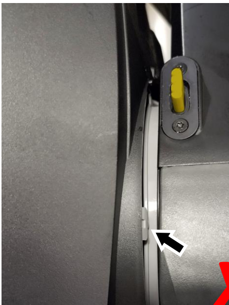
Incorrect – onglet à l'extérieur
